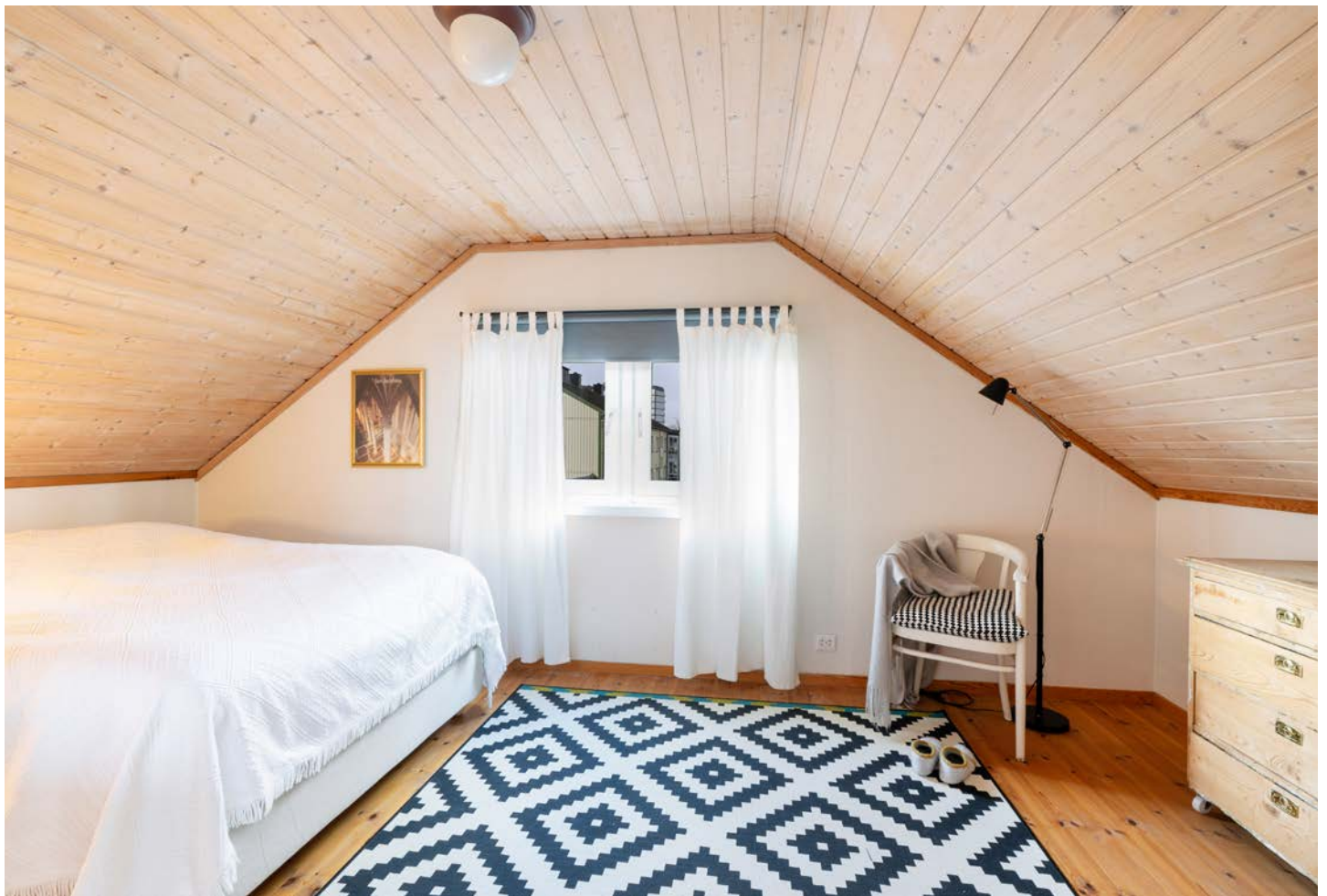
Soverom - Vinduer loft soverom er litt for små til å tilfredsstille dagens krav
