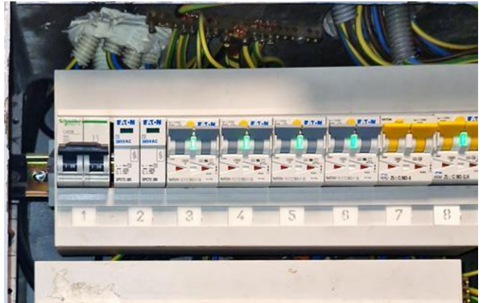
Elektrisk anlegg - [Sikringskap]
