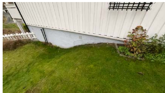
Manglende fuksikring mot grunnmur.
