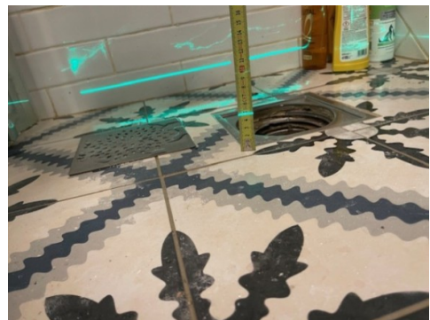
Lokalt fall i dusjsonen
