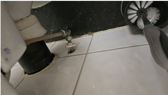
Svertesopp i fuger.
