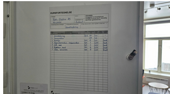
Kontroll el-skap leilighet.
