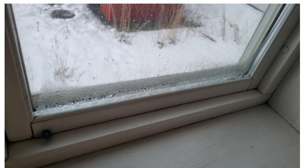
Det er påvist tegn på innvendig kondensering av enkelte vindusglass.
