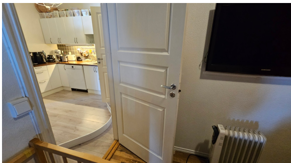
Småskader på innerdører.
