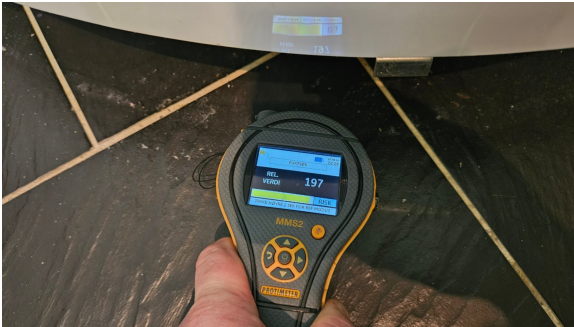
Fuktmåling viser svakt forhøydte verdier.
