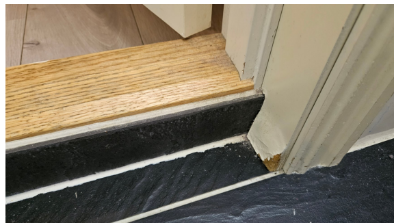
Dørforinger baddør er fuktsvellet.
