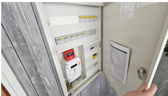
Kontroll el-skap felles gang.
