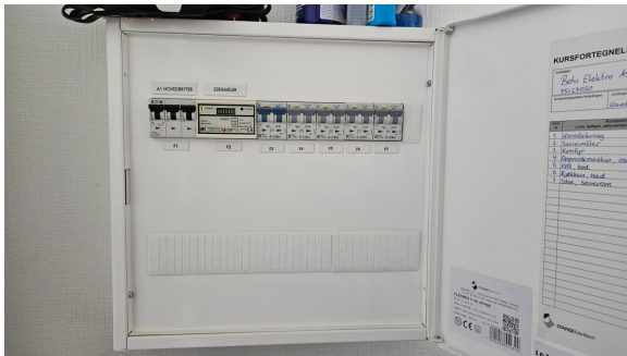
Kontroll el-skap leilighet.
