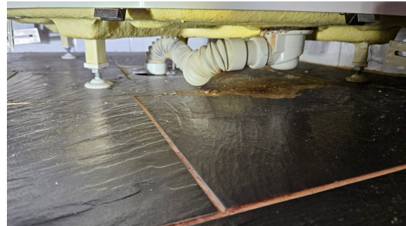
Lekkasje vannlås dusjkabinett.
