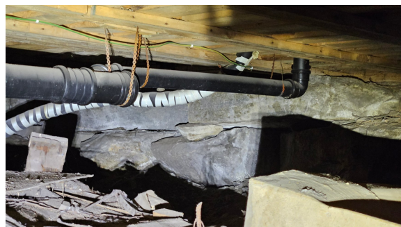
Vannledning i krypkjeller.
