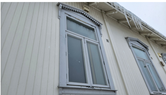
Værslitte vinduer, omramming går helt ned på vannbord.
