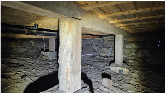
Det er ikke fuktsperre på grunnen.
