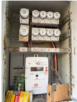
Sikringskap på adkomsttaltan utvendig.
