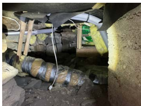
Krypkjeller under deler av badrom. Kun kontrollert fra luke.
