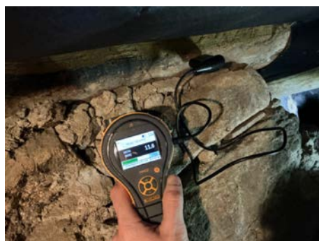
Fuktmåling (stikk kontroll). Ingen unormale utsalg registrert.
