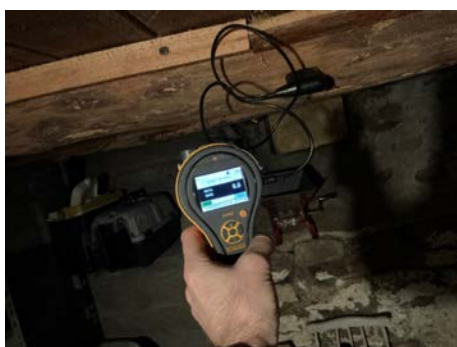
Fuktmåling (stikk kontroll). Ingen unormale utsalg registrert.
