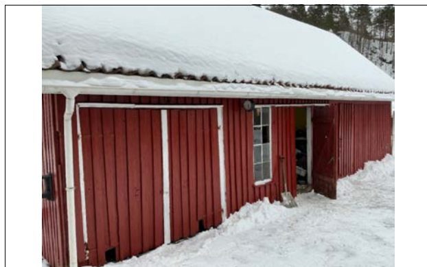
Eldre og slitt fasade på denne side
