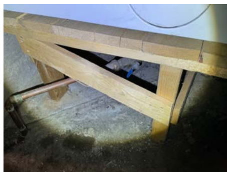
Stoppekran i grovkjeller. Funksjon ok.
