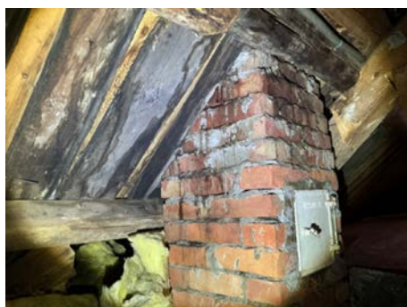
Gjennomføring av ene pipe. Tørr ved befaring. Skjolder antas å være «gamle»
