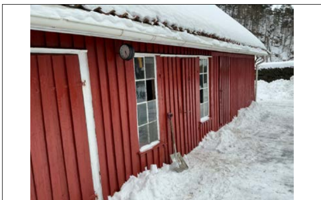
Flere manglende glass i eldre vinduer
