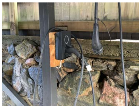
El.bil-lader ved carport.
