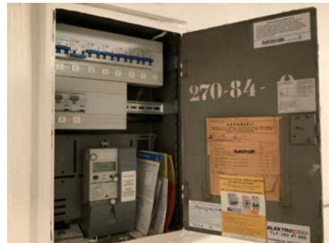
Sikringskap står plassert i felles trapperom.
