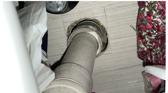
Ikke tett mellom rørgjennomføring og vegg i skap under vask.
