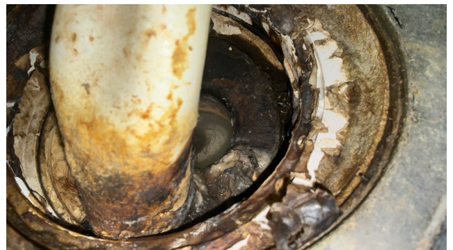
Sluk under dusjkabinett.
