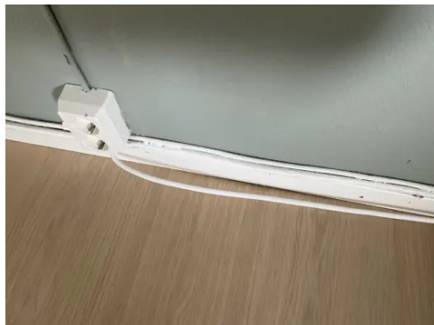
Løse ledninger i soverom.
