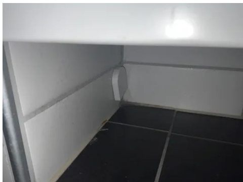
Avrenning til/i bad.
